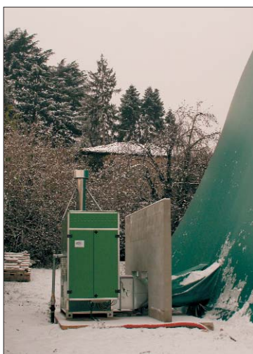
Sopra, l'impianto di riscaldamento posto all'esterno; a destra, un particolare della copertura; sotto, al colmo, il canale di destratificazione dell'aria. In basso, ulteriori dettagli della struttura, in particolare in corrispondenza del tamponamento laterale.
